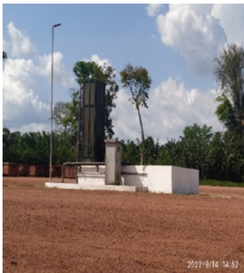
Figura 4 – Torre de resfriamento.
