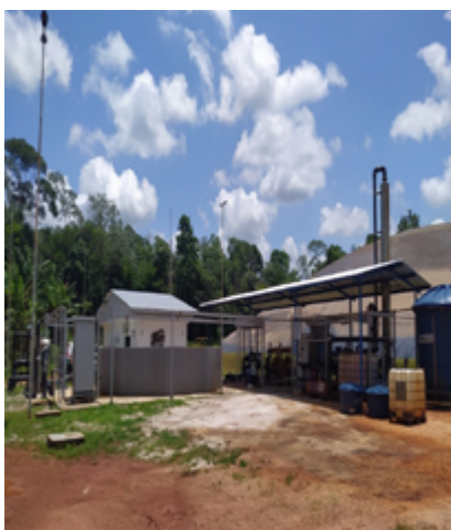
Figura 8 – Lavador de gases.
