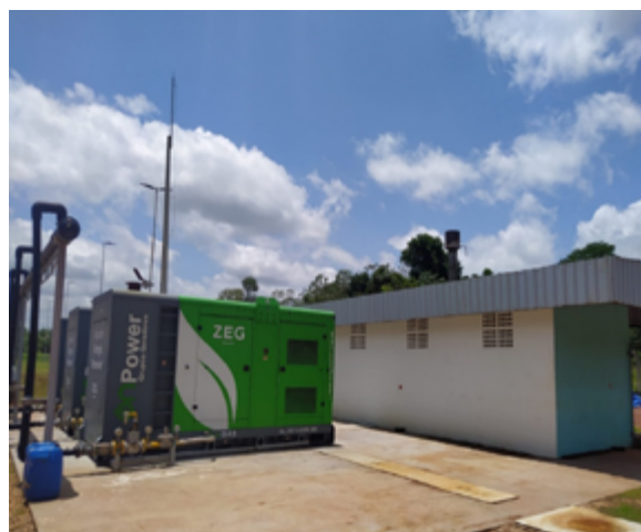
Figura 9 – Geradores de energia.
