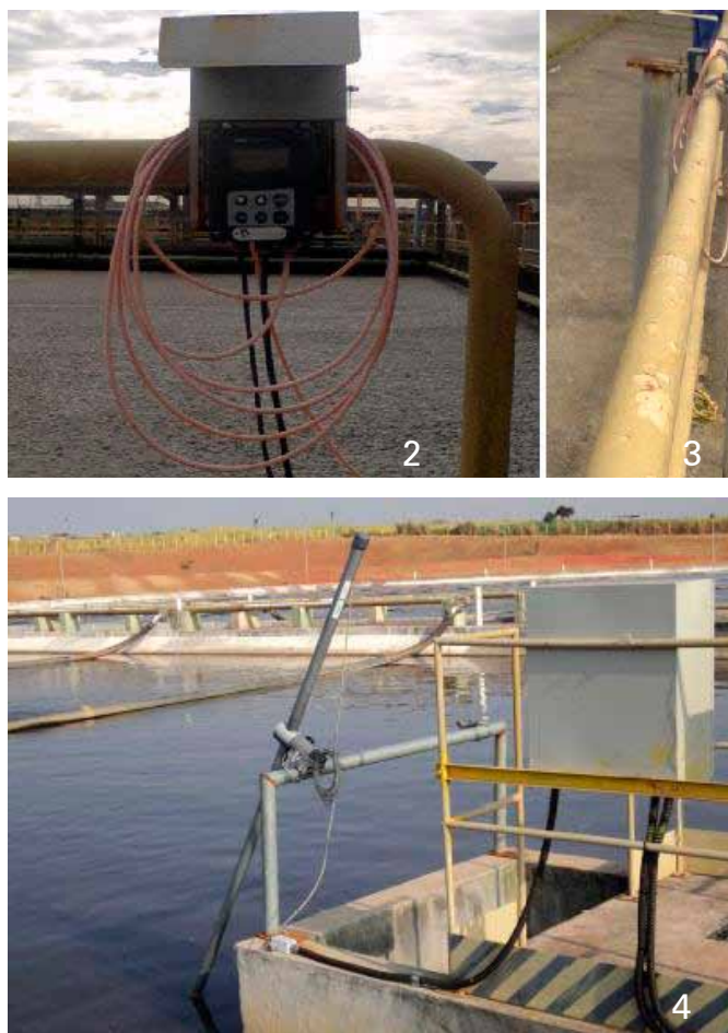
Figuras 2 a 4: (2 e 3) Sensor por membrana instalado na ETE Barueri. (4) Sensor por luminescência instalado na ETE de Paulínia.
