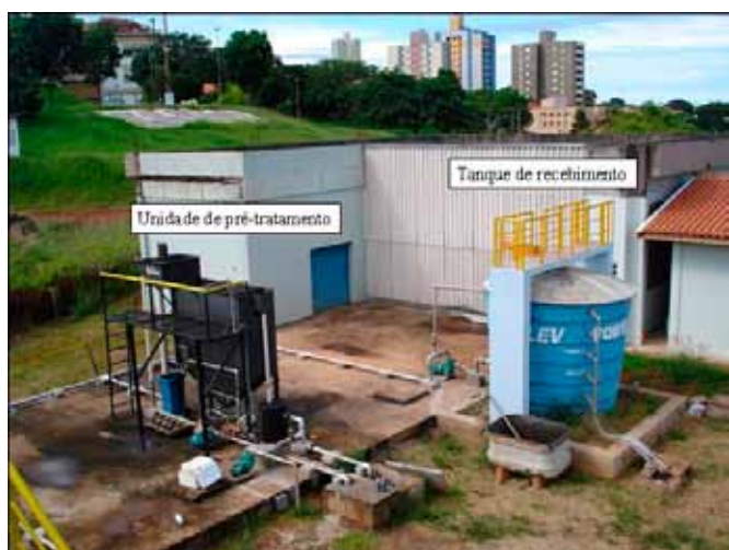
Figura 1 – Foto do sistema experimental: unidade de pré-tratamento e tanque de recebimento
