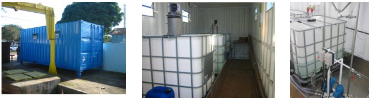
Figura 3- Estrutura, instalações e equipamentos de dosagem de ácido peracético
