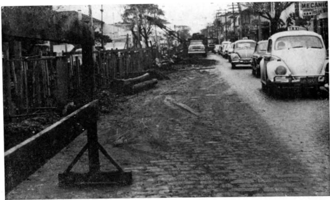
Fig. 2 — Além do perigo, a falta de sinalização e de planejamento na execução da obra, acarretam congestionamentos.
