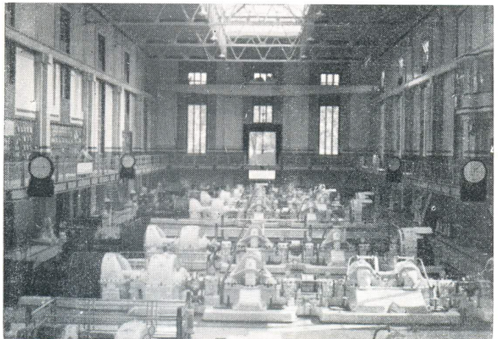
Fig. 24 — LONDRES — ETA Hampton — Conjunto de motores-bombas e geradores da estação. O edifício ao lado apresenta a instalação de caldeiras onde carvão é queimado para produção de vapor e de energia.
