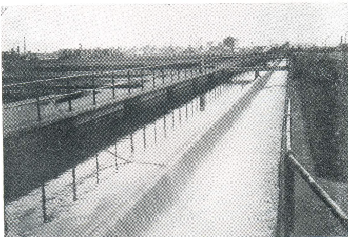
Fig. 10 — LONDRES, Northern Outfall Works — Decantadores primários.
