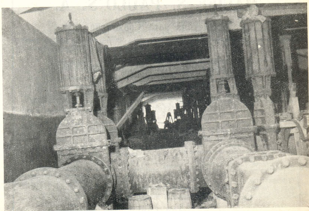
Galeria de canalizações dos novos filtros
