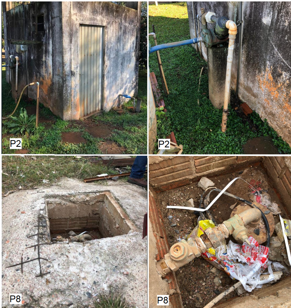
Figura 2 – Caracterização das condições construtivas e de conservação do entorno dos poços enquadrados como risco elevado de vulnerabilidade (P2 e P8).
