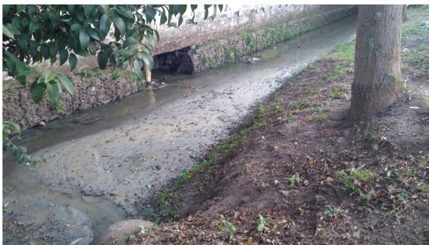
Figura 7 - Assoreamento em trecho do Córrego Tenente Rocha.
