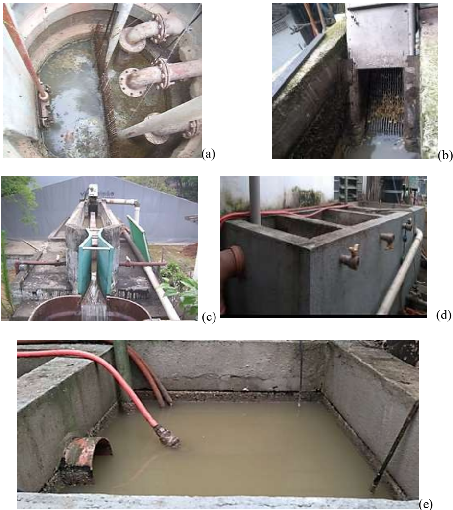
Figura 1 – Vista da EE e do Tratamento Preliminar. a - Elevatória de Esgoto; b - Peneira; c - Canal de Areia e Calha Parshall; d - Caixa de Gordura; e - Poço de Alimentação
