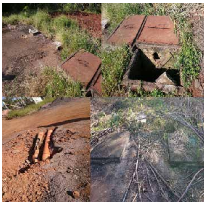
Figura 2: Estação de Tratamento de Efluente 2.
