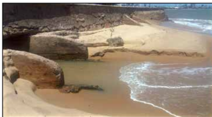
Figura 3 – Galeria pluvial com ocorrências frequentes de despejo clandestino de esgoto na Praia de Manaíra, João Pessoa.
