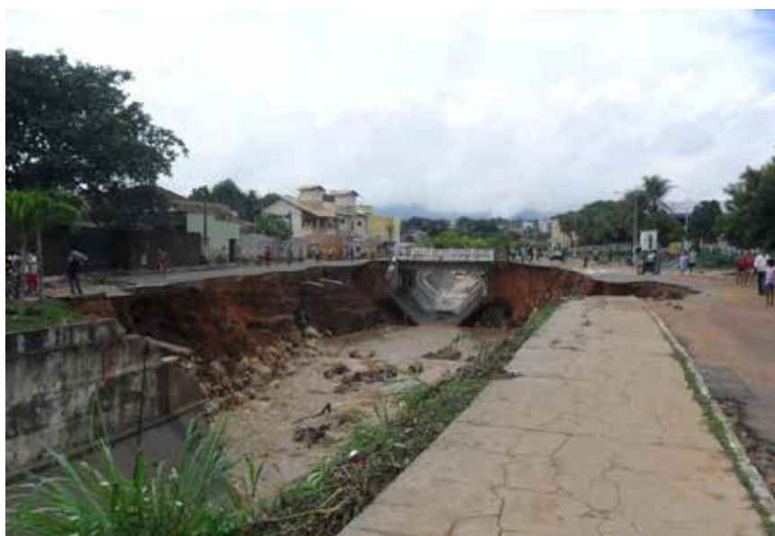
Figura 6: Canal do rio Granjeiro destruído após evento de chuva ocorrido no ano de 2011
