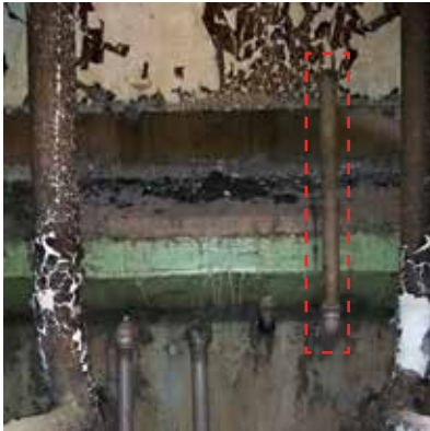
Figura 3 – Instalação de ponto de amostragem de lodo bem acima do limite do compartimento de decantação, em desacordo com o projeto.
