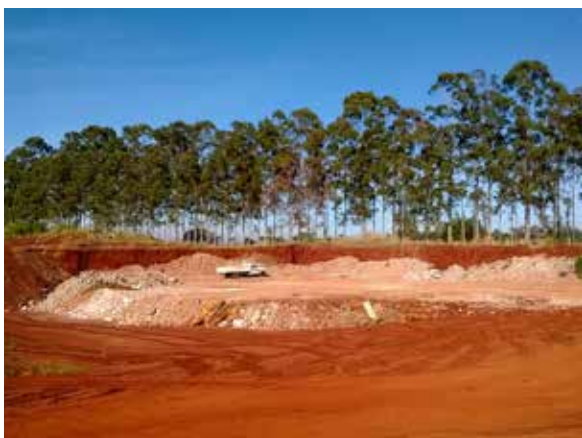
Figura 2 - Aterro de RCC classe A e resíduos inertes em operação desde 2014.
