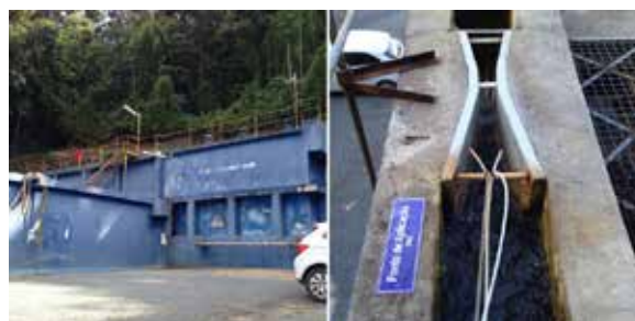
Figura 10 – ETA onde há coagulação, floculação e decantação.
