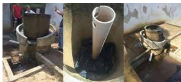
Figura 14 – Lavador de areia.
