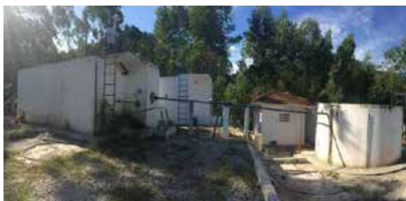
Figura 5 – ETA da Claraíba (ainda em ampliação), Nova Trento.
