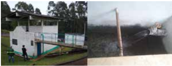
Figura 11 – ETA onde é utilizada aeração.
