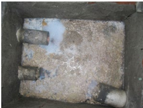
Figura 14 – Caixa de gordura irregular, sem sifão (curva/joelho) para a retenção da gordura.
