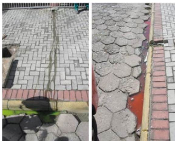
Figura 13 – Águas servidas das pias de churrasqueira ligadas diretamente à rede pluvial.
