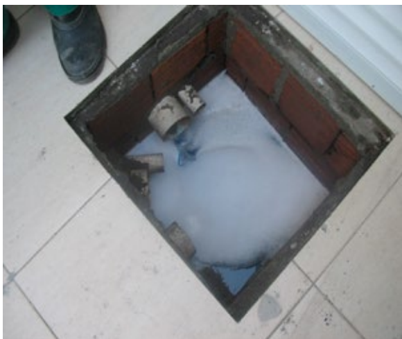
Figura 12 – Águas servidas da área de serviço direcionadas à caixa de gordura.
