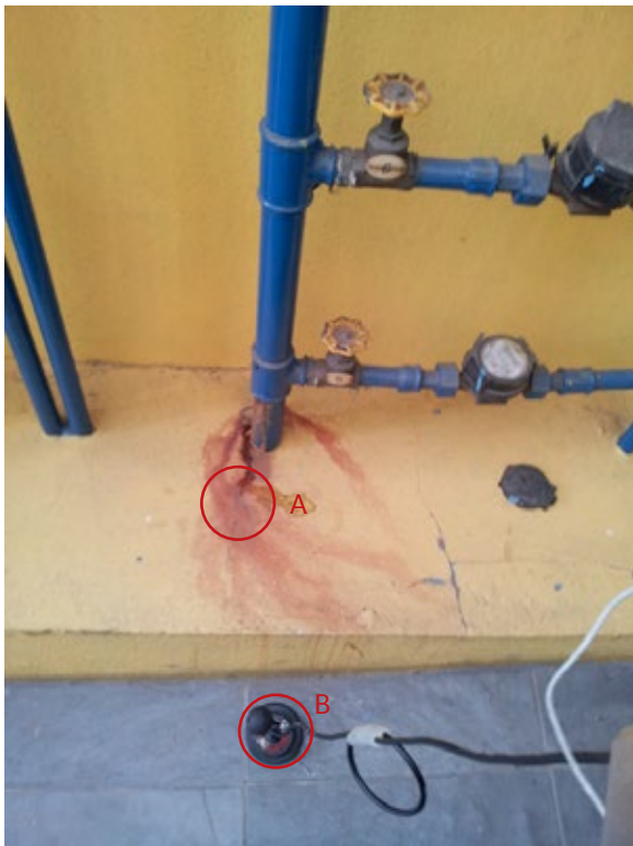
Figura 3 – Fotografia do cavalete em que estava o vazamento do primeiro estudo de caso, em que se podem observar dois pavimentos distintos (A – cimento, com pintura amarela, e B – cerâmica, onde está o sensor).
