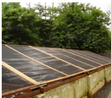
Figura 2 – Tanques de aeração I e II
